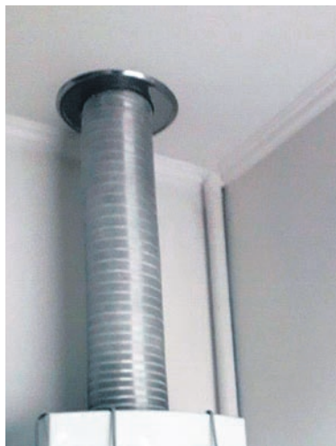
Sufit podwieszany zakrywa połączenie do kominu spalinowego
