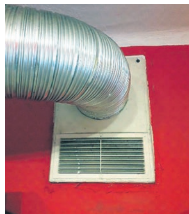
Rura z okapu kuchennego podłączona do wentylacji. Zbyt mały przekrój kratki wentylacyjnej
