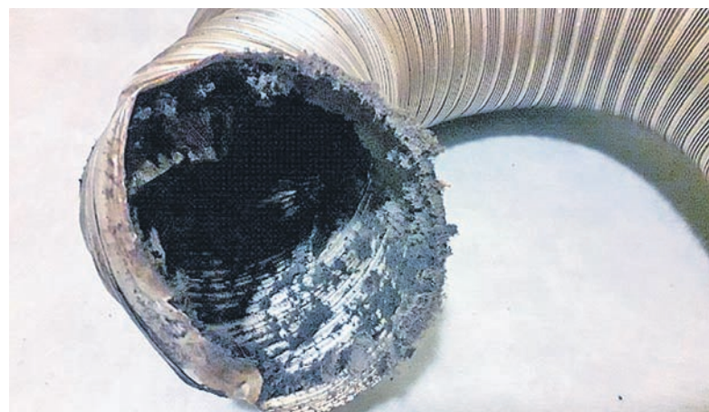
Aluminiowa zabrudzona rura spalinowa
